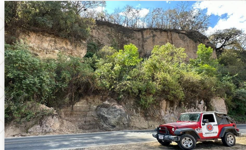
Monitoreo de derrumbes sobre la carretera Almoloya – Zacualpan.
